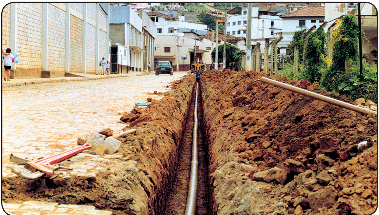
Foto 6 – Rede de distribuição em PVC PBA
