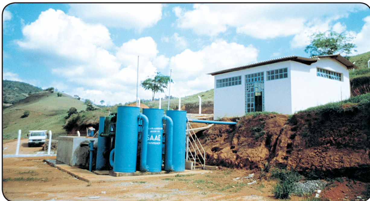
Foto 4 – ETA compacta com casa de química
