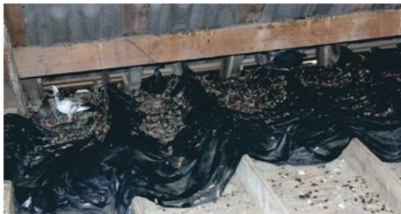
Figura 16. Fezes de pombas-domésticas em forro de prédio público.
